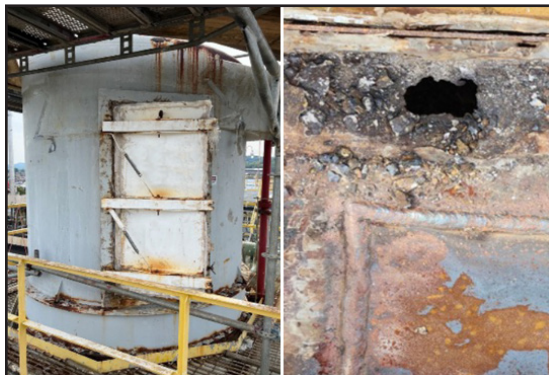
腐食した壁のあるバグハウス構造
